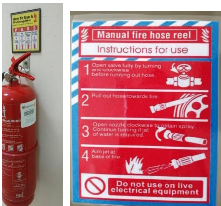
Peralatan Pencegahan Kebakaran
